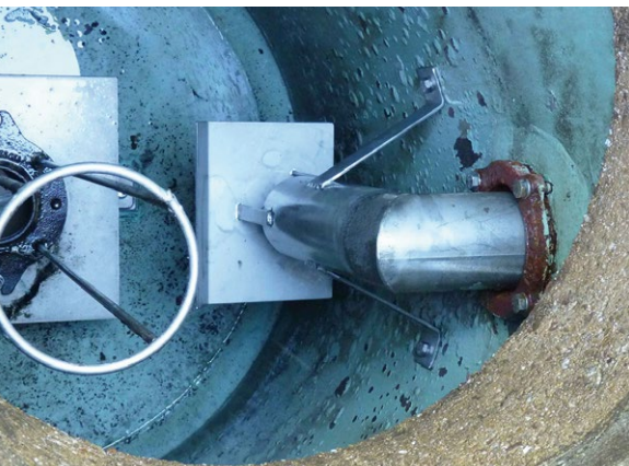
Bei der Prüfung häufig zu erkennen: Die Beschichtung eines herkömmlichen Betonabscheiders ist defekt. Die Sanierung bedeutet Stillstandszeit und führt meist zu hohen Kosten!
