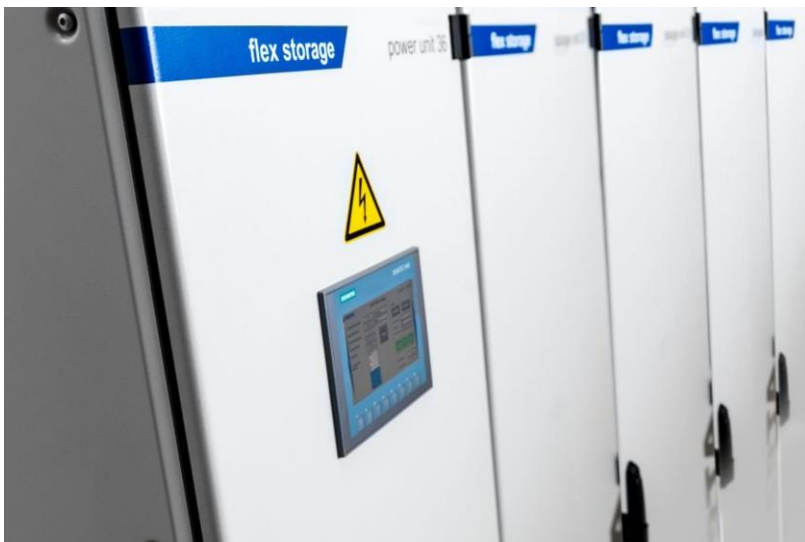
Der Lithiumionenspeicher VARTA flex Storage kommt bei der Firma Mayer erfolgreich zum Einsatz. Quelle: VARTA
