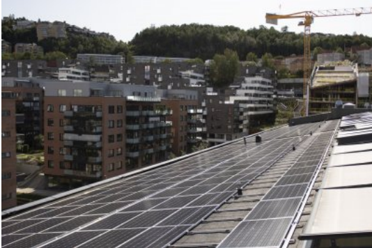
Aufdachanlage auf dem Bürogebäude in der Smeltingen 1 in Oslo
