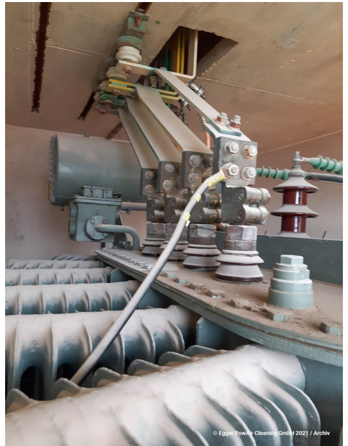
„Offene Stromschienen“ die unter Voll-Last mit Kalter Trocken Druck Luft und sonst nichts... gereinigt werden
