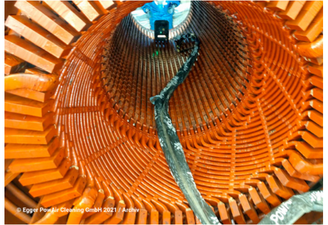
Der Generator nach der berührungslosen Reinigung mit KDL - Verfahren
